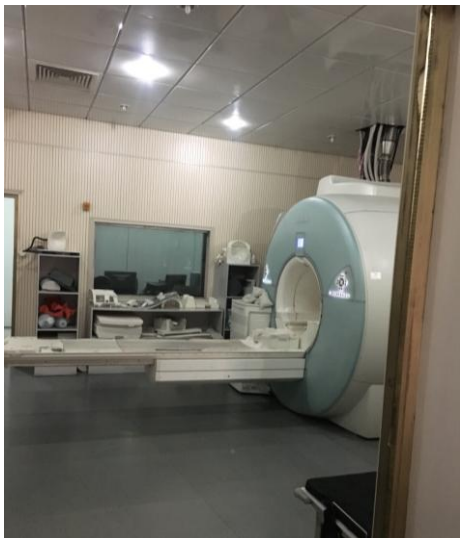
图 6-11 3#病房楼放射科 5 号机房（磁共振仪）
